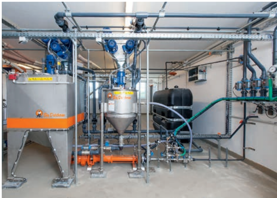
Hranidbena kuhinja: sistem sa 2 spremnika sa spremnikom vode za ispiranje
