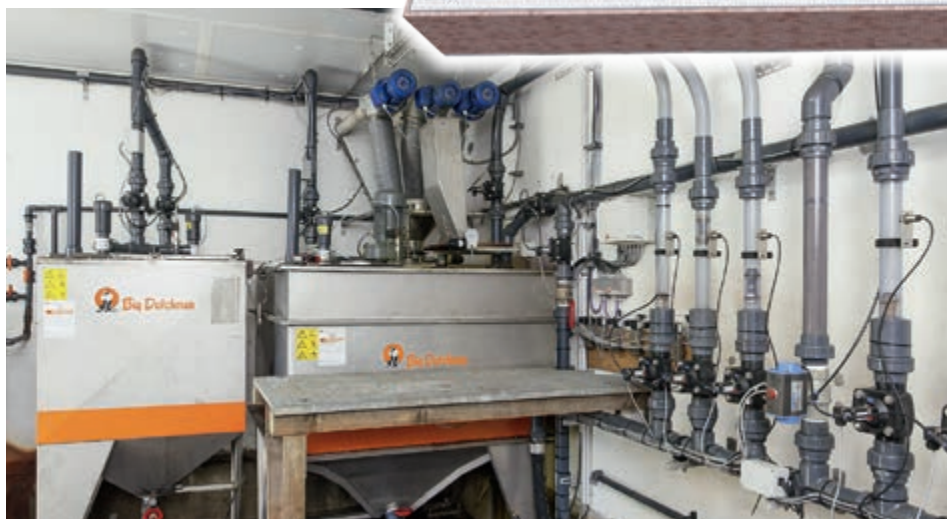
Hranidbena kuhinja: sistem sa 1 spremnikom sa spremnikom vode za ispiranje i četiri JET linije za grananje
